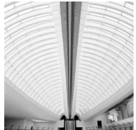
Brandschutzanstriche sind glatt und unterscheiden sich optisch nicht mehr von normalen Anstrichen: Kuppeldach Universität Zürich, 2004 (Foto: S. Rötheli, Zürich)
