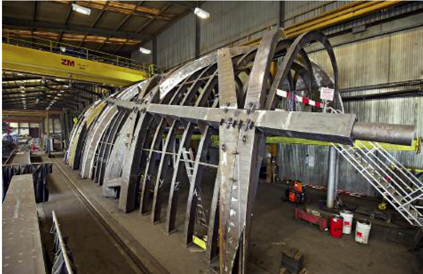
Zur Überprüfung der Passgenauigkeit wurden die einzelnen Stahlelemente bereits im Werk vormontiert.
