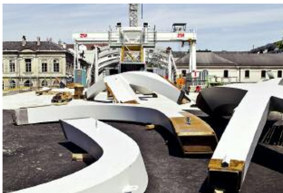
Vorgefertigte Elemente vor der Montage (links); zusammengeheftete Konstruktion vor dem Verschweissen (rechts)
