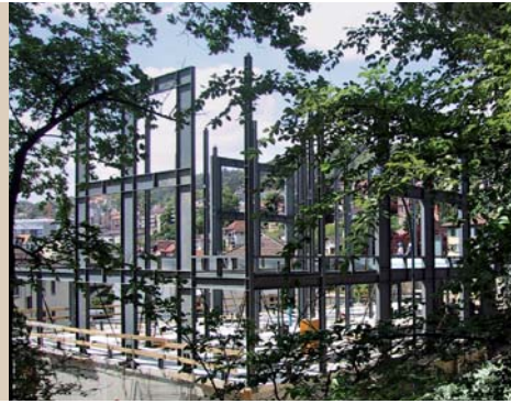
Ecole de la Maladière, Neuenburg: Dreigeschossige Vierendeel-Rahmen bilden in jeder Fassadenebene eine aussteifende Scheibe.
